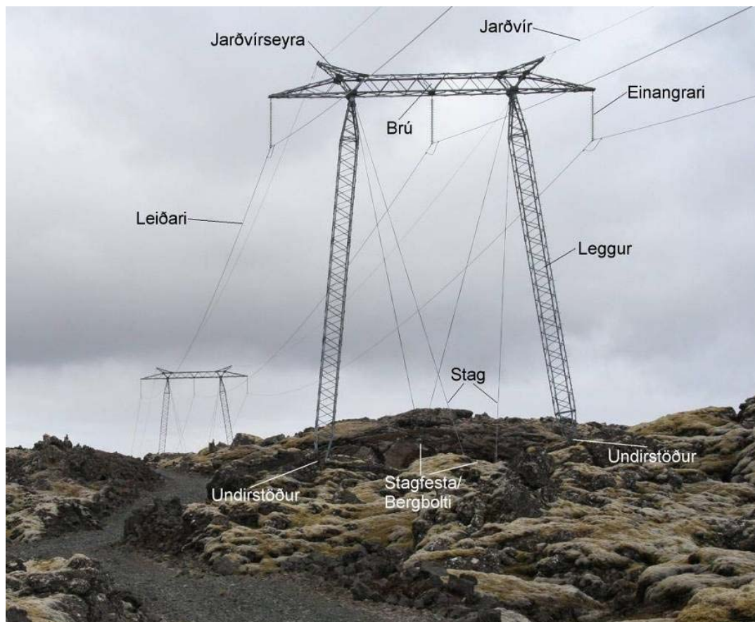
Mynd 1 Dæmigerð 220 kV lína
